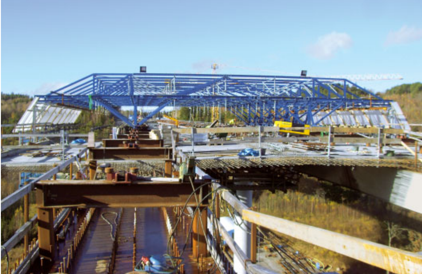
3 3 Kansilaatan alapuolinen muotti roikkuu siltavaunun teräs- ristikkorakenteiden varassa. Itse siltavaunu lepää kotelo- palkkien päällä.
