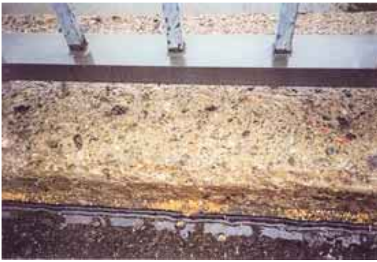
3 Kuva sillan vaurioituneesta reunapalkista. Silta on valmistunut vuonna 1983.
