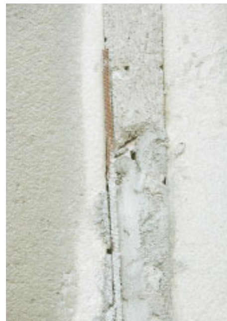
1 Sisäkuorielementtien saumassa on saumateräs jäänyt ilman suojaabetonia.
