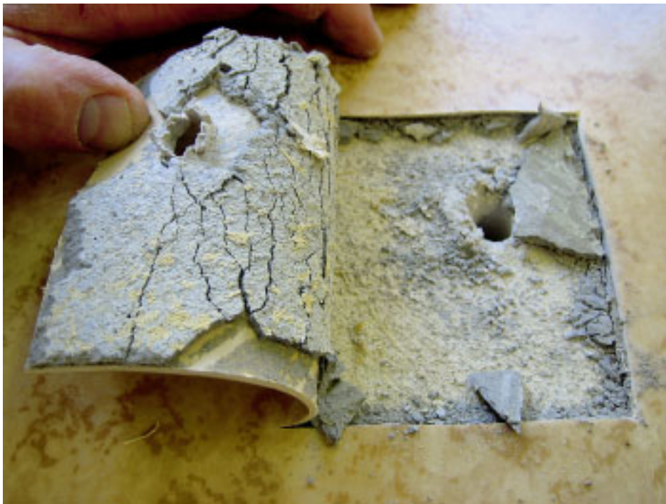
7 Joskus lattiarakenteen emissiot johtuvat puutteellisesta vanhan betonin puhdistamisesta. Kuvassa tasoitteen alla on orgaanista materiaalia.
