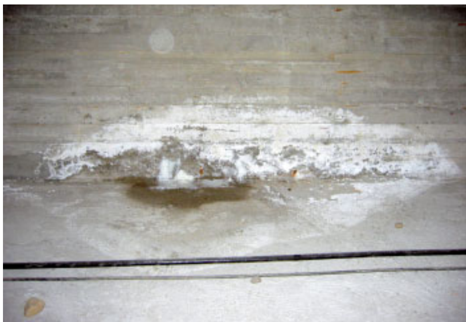
1 Vesivuoto kotelopalkin ja alalaatan liittymäkohdassa kotelon sisällä Savilahden sillassa.
