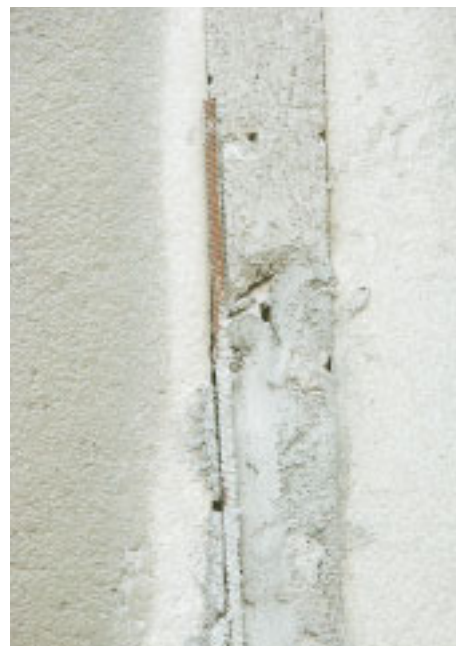
1 Sisäkuorielementtien saumassa on saumateräs jäänyt ilman suoja-betonia.
