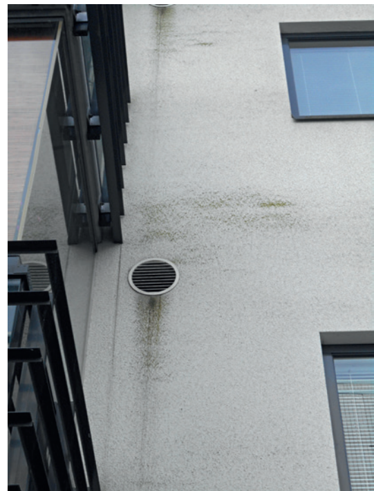
17 Julkisivun pienimuotoista leväkasvustoa
