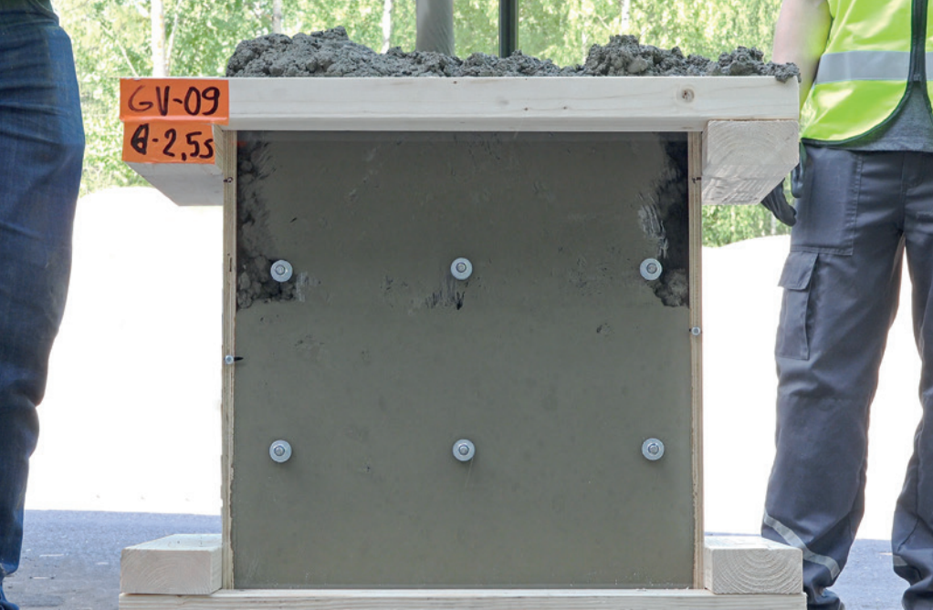
Kuva 4 Betonin tiivistys ei ole vielä riittävä. Muotin nurkat ja raudoituksen viereiset alueet eivät ole täyttyneet betonilla.
