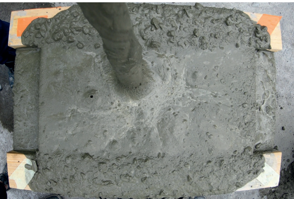
Kuva 6 Betonin optimitiivistysaika on ylitetty. Sementtipasta on erottunut betonipinnalle, tämä näkyy myös vaaleampana "vaahtona" pinnan keskiosassa. Tiivistysilman poistuminen jatkuu vielä tässäkin vaiheessa. Erityisesti huokostetuilla betoneilla erottuminen voi alkaa jo ennen kuin kaikki tiivistysilma on saatu poistettua betonista.
