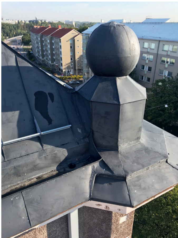
14 Peltikatto kulmatorneineen olivat huonossa kunnossa ennen korjausta.
