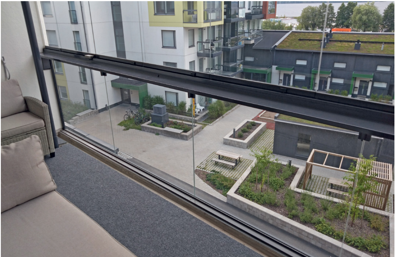
6 Lasirakenteisten parvekekaiteiden tarkastamista koskien on julkaistu RT-kortin ohje (RT 103757) vuonna 2024.
