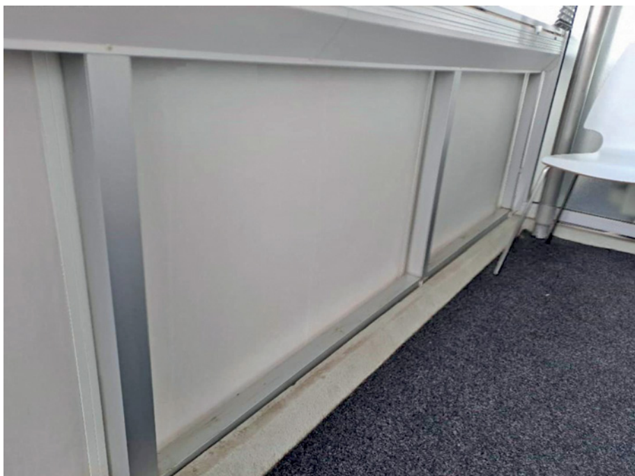
8 Laskentaesimerkkitarkastelun mukainen levykaide Lensun työstä, jossa laskennallisen tarkastelun perusteella levy ei kestä 0,3 kN pistekuormaa.
