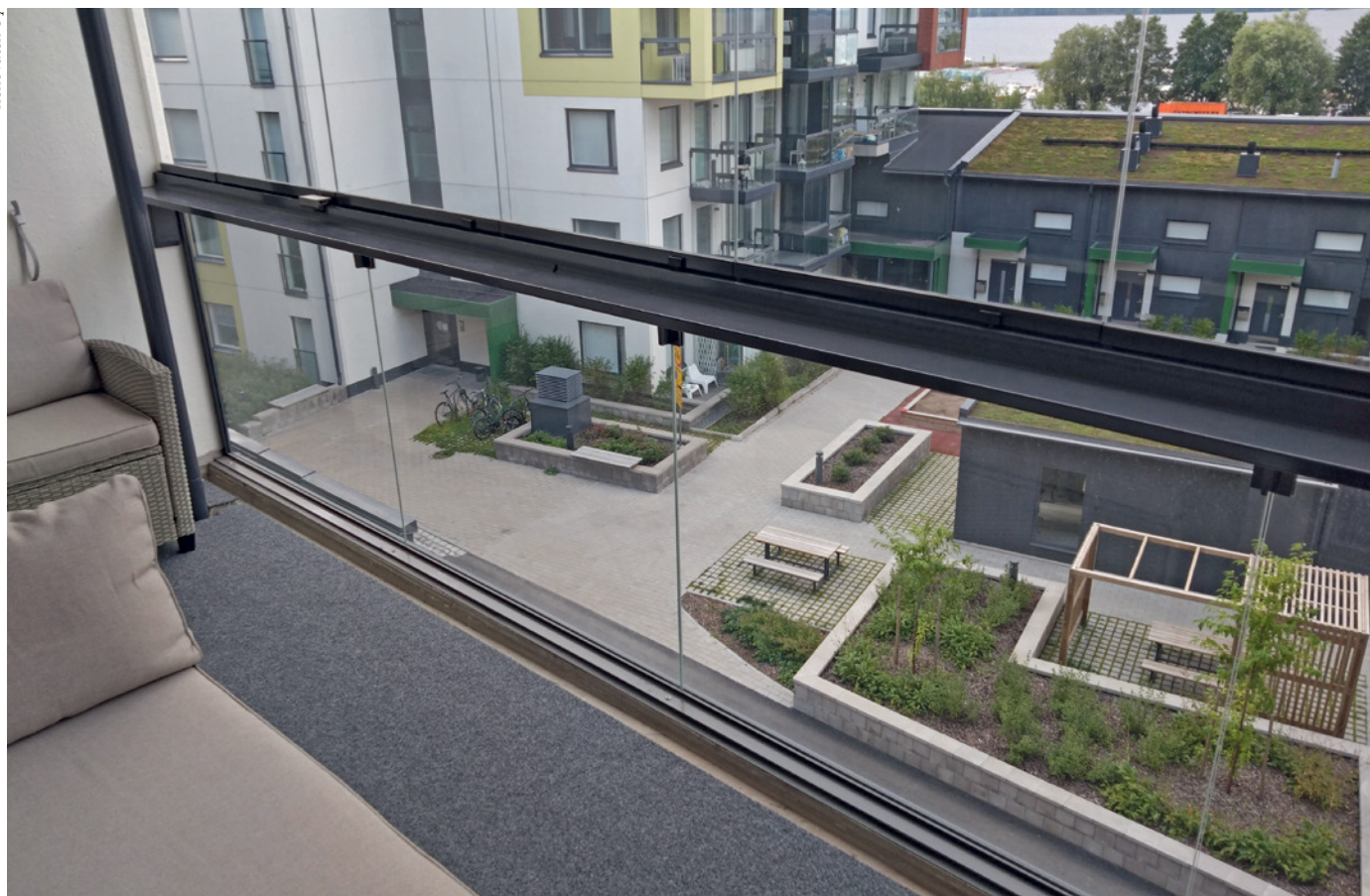
6 Lasirakenteisten parvekekaiteiden tarkastamista koskien on julkaistu RT-kortin ohje (RT 103757) vuonna 2024.
