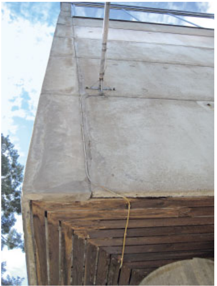
7 Uimahalliosan elementtien nurkkien lohkeamat ja paikoitellen pintaosistaan rapautunut betoni aiheuttivat ennen korjausta lähes turvallisuusriskin. Myös seinän lämpöeristysominaisuudet olivat kaukana nykyvaatimuksista.
