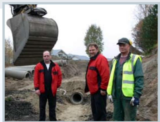
”Kuusamontien sadevesiviemäröinnin rakentamisessa käytetään yhteensä 6,3 kilometriä betonista EK-putkea”, työmaamestari Ari Niskanen Niska & Nyssönen Oy:stä sanoo. Vieressä työpäällikkö Jorma Härkönen ja asentaja Aaro Minkkinen.
