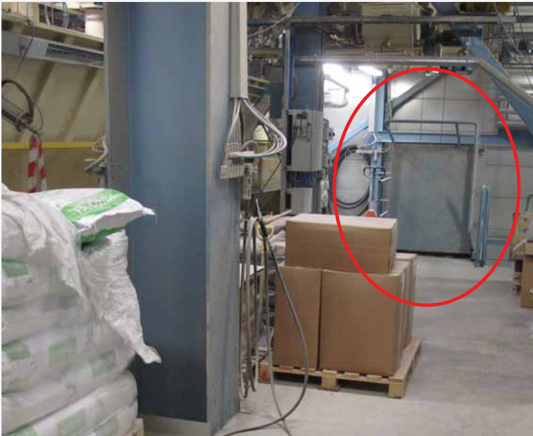
Lakan Betoni Oy, Forssan kuivatuotetehdas Vesa Hapuoja
