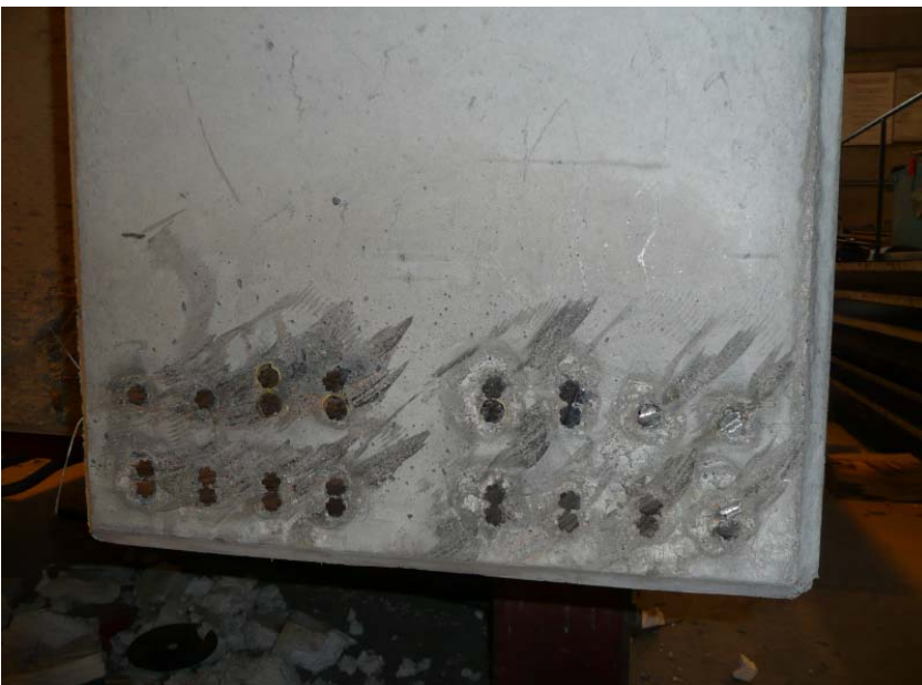
Kuva 7. Katkaistaessa jännepunoksia kulmahiomakoneella osutaan aina samalla myös kovettuneeseen betoniin aiheuttaen pölypäästöjä.
