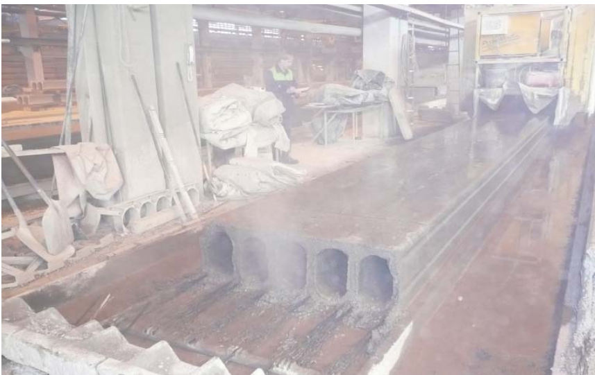
Kuva 10. Ontelolaatan pituussuuntainen sahaus aiheuttaa runsaat pölypäästöt jotka saattavat levitä kauas sahauskohdasta laatan onteloita pitkin.
