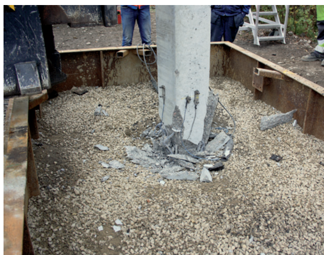
2 Kaikki murtoon asti kuormitetut paalut murtuivat alapäästään.
