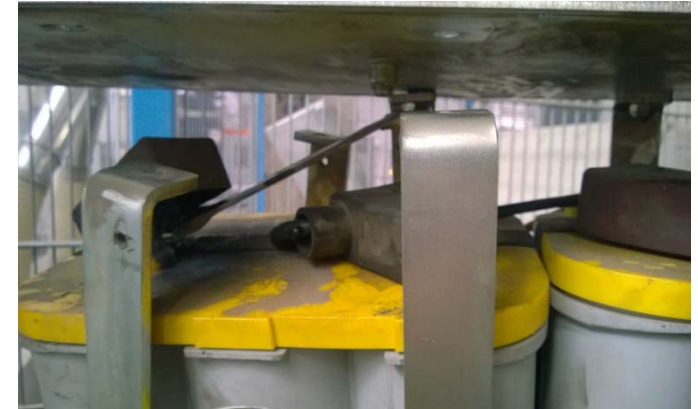
Kiintoavain jäi + navan ja mutterin väliin aiheuttaen oikosulun ja valokaaren
