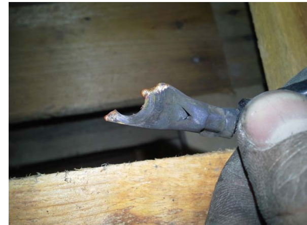
Viimeisen (4.) akun kiinnitysruuvien alla rungossa ollut 0-navan liitin sulki oikosulun seurauksena.
