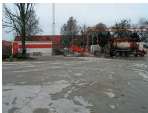
Yleisnäkymä pesulaitteistosta. Suotopuristin rakennuksen sisällä vasemmalla
