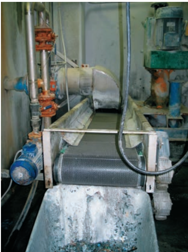
Kuva 27. Seulaverkko kuljetinhihnana erottelee karkeat jakeet betonilietteestä ennen selkeytintä
