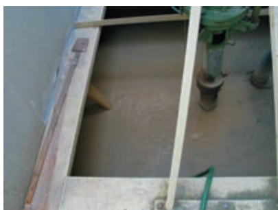
Pesurin ylivuoksu johdetaan sekoitussäiliöön
