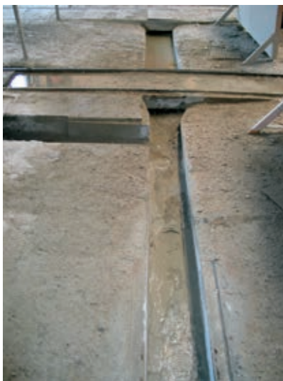
Lattiakanaalien yleinen ongelma
