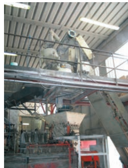
Märkäbetoniasema valukarusellin yläpuolella. Selkeytyslaitteisto välittömästi seinän takana oikealla
