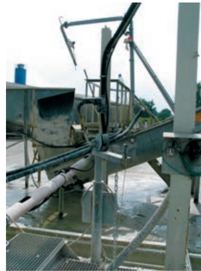
Ruuvipesurin syöttöpää Huom. aukot slurry-putkessa/ kanavassa.
