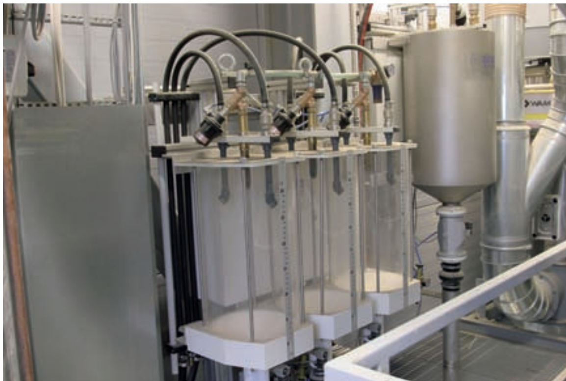
Moderni betoniasema muistuttaa steriiliä laboratoriota, jossa laitteistot ja putkistot ovat alansa uusinta high tech-teknologiaa. Kuvassa betoniaseman lisäaineiden annostelulaitteistoja.
