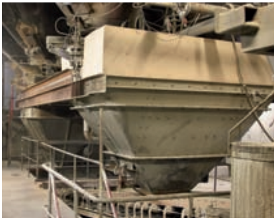
Nykyaikaisella betoniasemalla kiviaines punnitaan sähköisesti suppilovaa'alta hihnakuljettimelle, joka kuljettaa sen edelleen betonisekoittimeen. Kuvassa Ruduksen Lappeenrannan tehtaiden modernisoitua betoniasemalaitteistoa.
