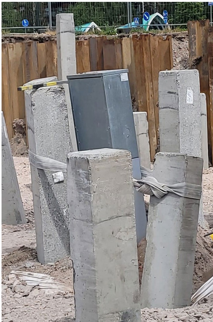
Kuva 3. Sähkökeskus paalujen keskellä.
