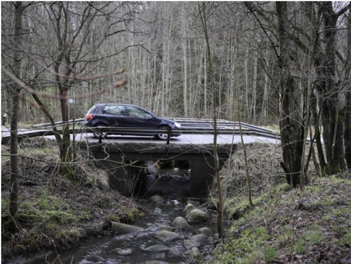
Pieni silta. Liikenneverkoissa syntyy koko ajan korjausvelkaa, raportti kertoo. KUVA: ANU KIVISTÖ
