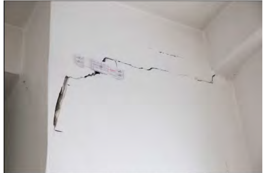
Kampuksen seinissä, lattioissa ja rakenteissa näkyy selkeitä halkeamia. Tällä mittarilla on seurattu vaurioiden pakenemista. Kuva: Esa Fills / YLE
